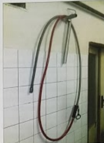
Drenčovací systém s nerezovou sondou
